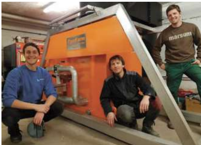
Fridolin Hanel und Stephan Gutzwiller von Pyronet GmbH sowie Landwirt Michael Kipfer in Stettlen freuen sich über die Installation der Pyrolyseanlage. (© Pyronet GmbH)
